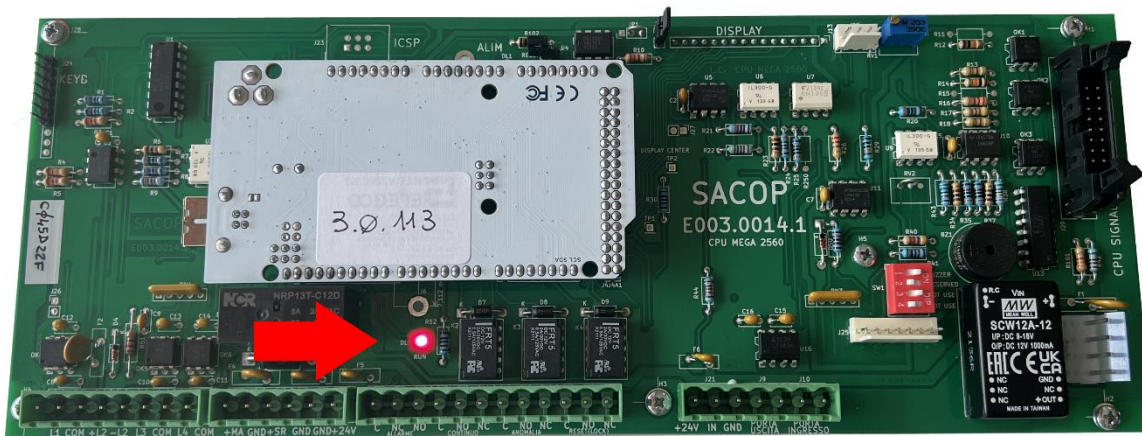
Figura 10 - Led ROSSO denominato DL5 RUN su scheda elettronica di alimentazione E003.0014
